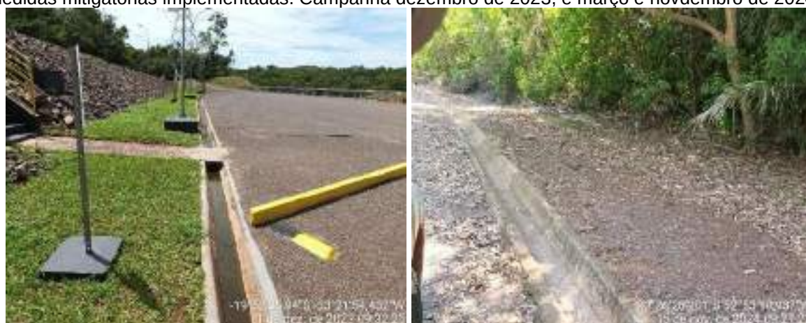
Figura 10 – Canaletas para escoamento de água nas vias de acesso da PCH Verde 4A, evidenciando medidas mitigatórias implementadas. Campanha dezembro de 2023, e março e novembro de 2024.
