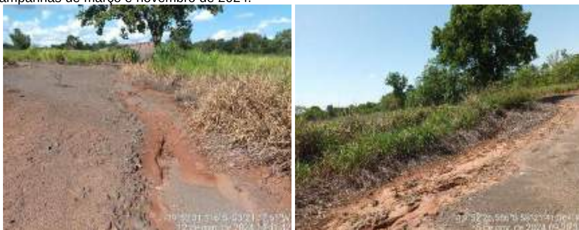
Figura 7 – Ponto 5: Erosão em sulcos, área 1 da PCH Verde 4A, no município de Água Clara/MS. Campanhas de março e novembro de 2024.
