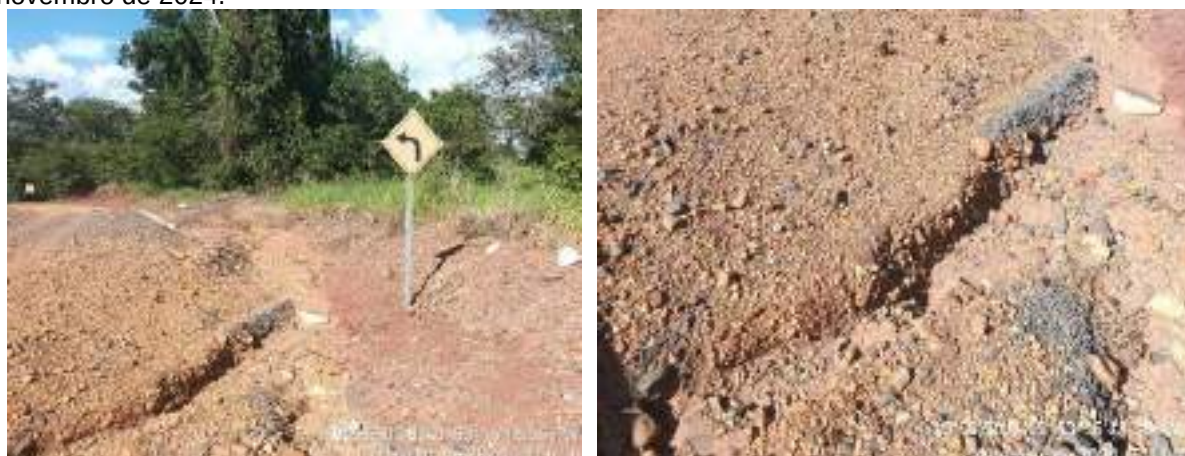
Figura 11. Ponto 5: Erosão em sulcos na lateral da via principal de acesso (A - C), e canaleta não finalizada (C), na área 2 da PCH Verde 4, no município de Água Clara/MS. Campanhas de março e novembro de 2024.
