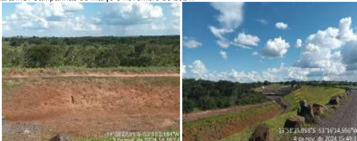
Figura 7. Ponto 4: Erosão laminar no acesso interno da área 1 da PCH Verde 4, no município de Água Clara/MS. Campanhas de março e novembro de 2024.
