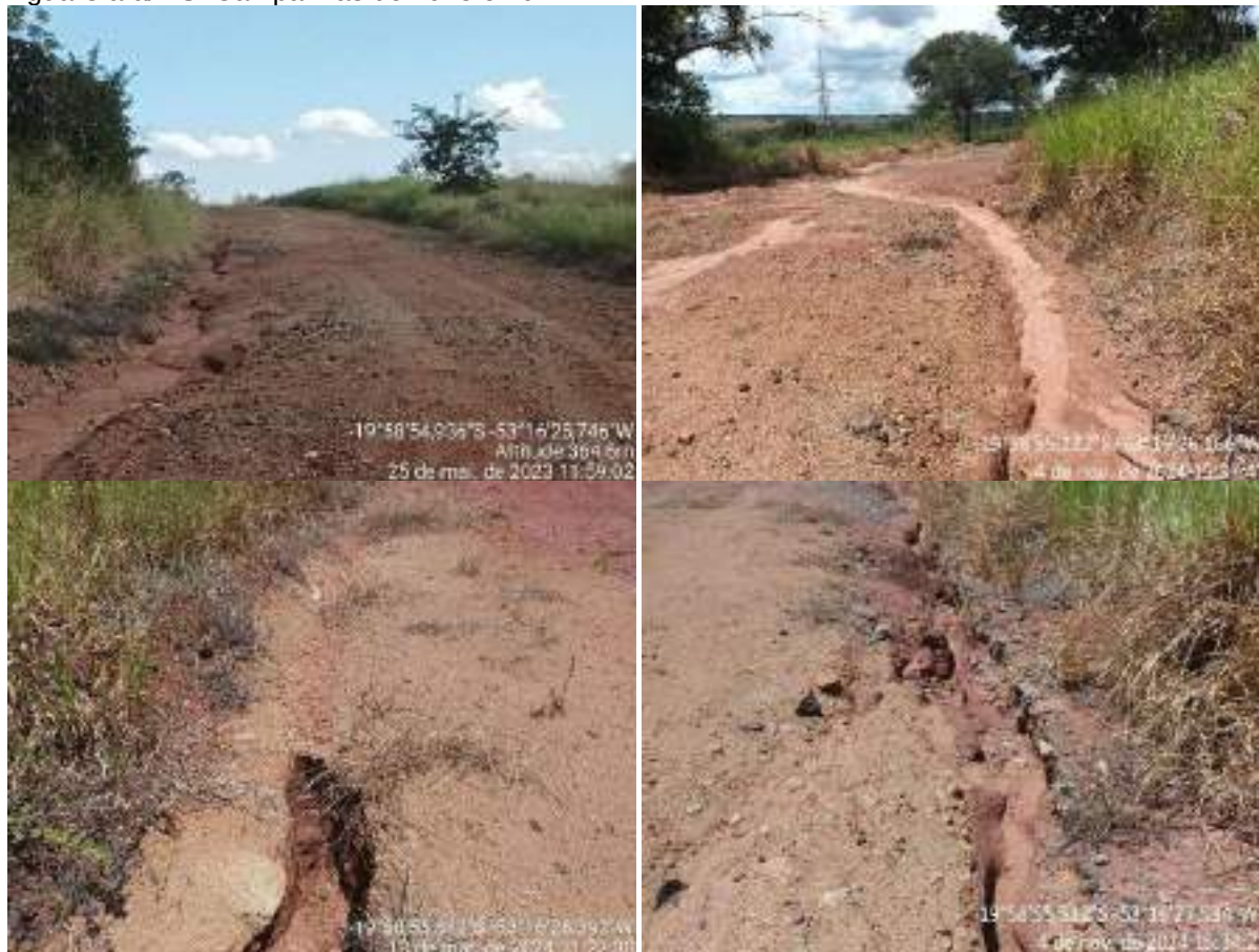
Figura 6. Ponto 3: Erosão em sulcos no acesso interno da área 1 da PCH Verde 4, no município de Água Clara/MS. Campanhas de 2023 e 2024.
