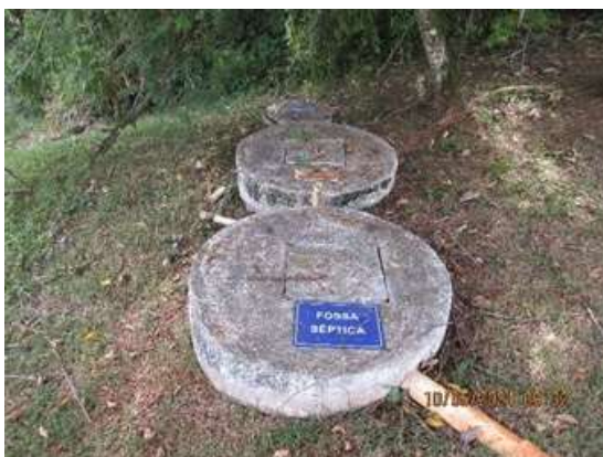
Figura 43 - Fossa séptica. Fonte: Cedro Inteligência Ambiental, Out/2024.
