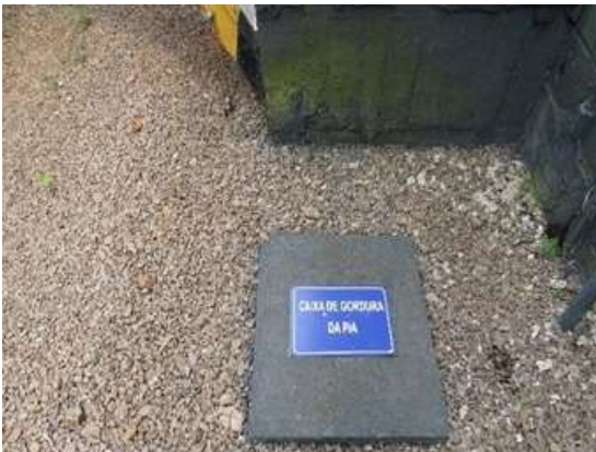
Figura 37 - Caixa de gordura para tratamento primário de efluentes. Fonte: Cedro Inteligência Ambiental, Maio/2024.
