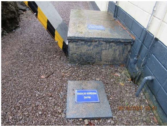
Figura 38 - Caixa de efluentes para tratamento primário de efluentes. Fonte: Cedro Inteligência Ambiental, Out/2024.
