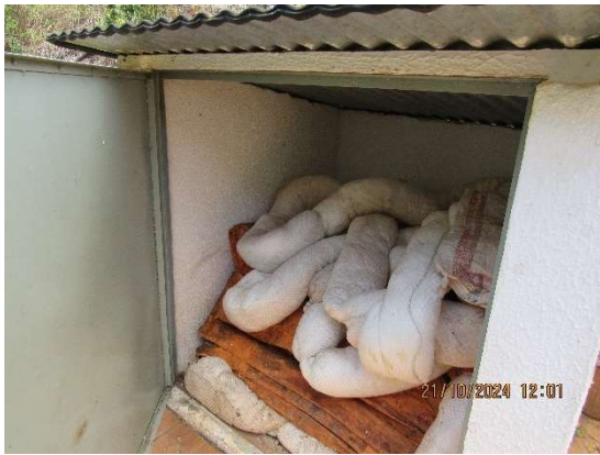
Figura 34 - Kit para derramamento de óleo, na área externa da usina. Fonte: Cedro Inteligência Ambiental, Out/2024.
