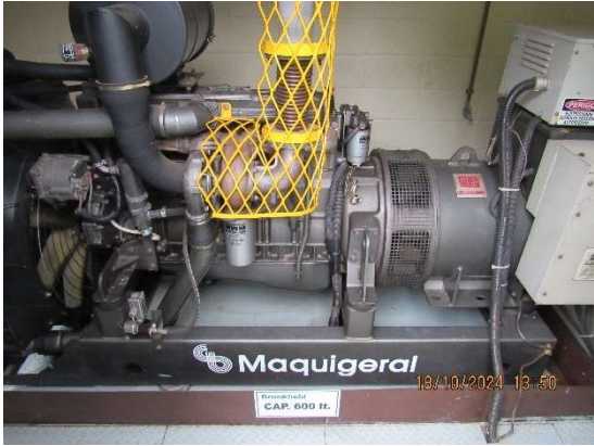
Figura 24 - Gerador diesel GMG. Fonte: Cedro Inteligência Ambiental, Out/2024.
