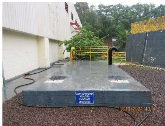
Figura 42 - Caixa separadora de água e óleo. Fonte: Cedro Inteligência Ambiental, Out/2024.
