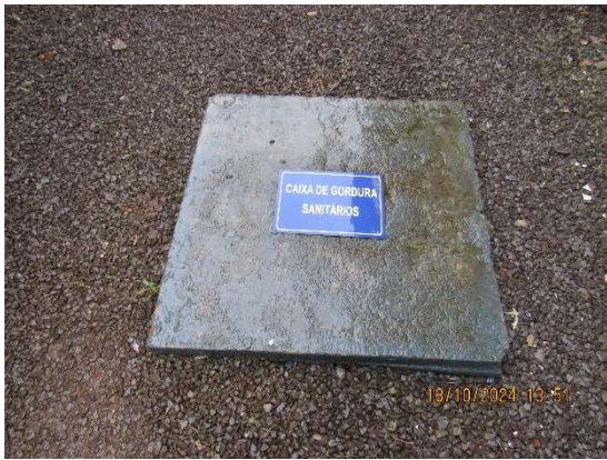
Figura 40 - Caixa de efluentes para tratamento primário de efluentes. Fonte: Cedro Inteligência Ambiental, Out/2024.
