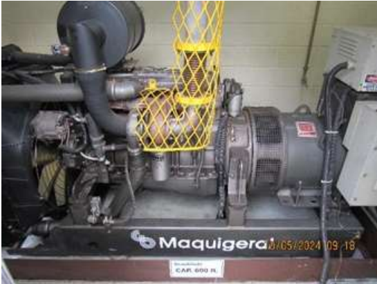
Figura 23 - Gerador diesel GMG. Fonte: Cedro Inteligência Ambiental, Mai/2024.
