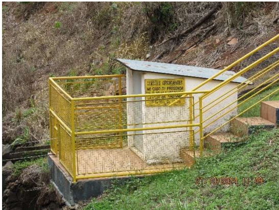
Figura 32 - Kit para derramamento de óleo, na área externa da usina. Fonte: Cedro Inteligência Ambiental, Out/2024.
