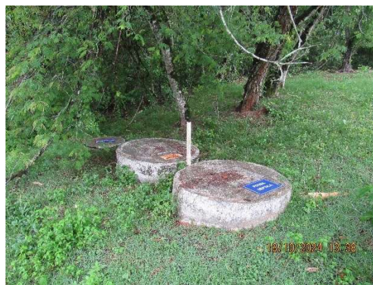
Figura 44 - Fossa séptica. Fonte: Cedro Inteligência Ambiental, Out/2024.
