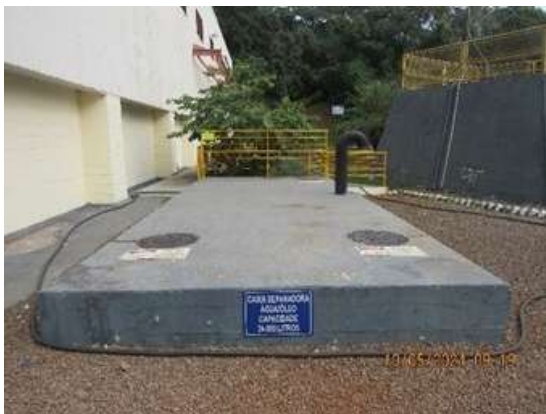
Figura 41 - Caixa separadora de água e óleo. Fonte: Cedro Inteligência Ambiental, Maio/2024.
