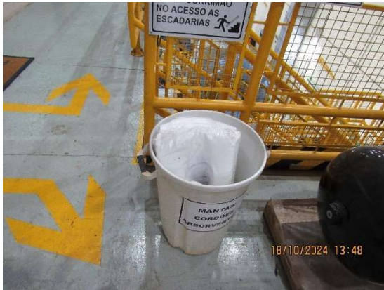
Figura 27 - Kit de mantas e cordões absorventes na área interna da subestação. Fonte: Cedro Inteligência Ambiental, Out/2024.
