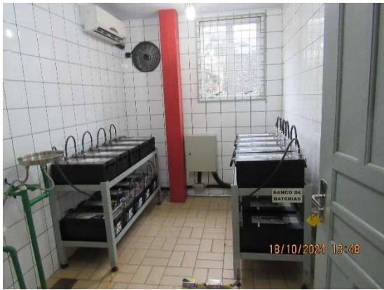
Figura 26 – Banco de baterias. Fonte: Cedro Inteligência Ambiental, Out/2024.
