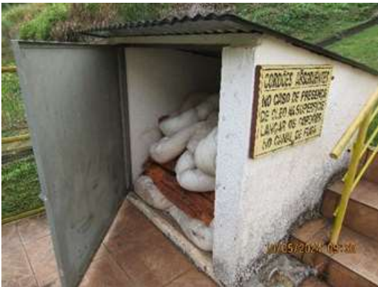
Figura 33 - Kit para derramamento de óleo, na área externa da usina. Fonte: Cedro Inteligência Ambiental, Mai/2024.
