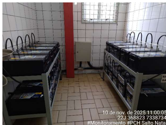
Figura 32 - Banco de baterias. Fonte: Cedro Inteligência Ambiental, nov./2025.
