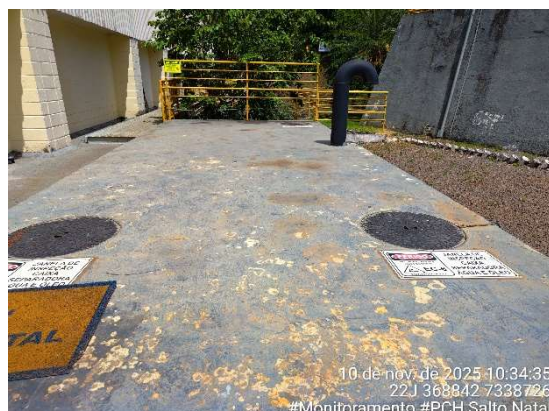
Figura 50 - Sistema separador de água e Óleo. Fonte: Cedro Inteligência Ambiental, nov./2025.
