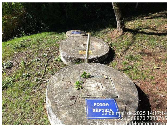
Figura 45 - Fossa séptica e Filtro anaeróbico. Fonte: Cedro Inteligência Ambiental, maio/2025.
