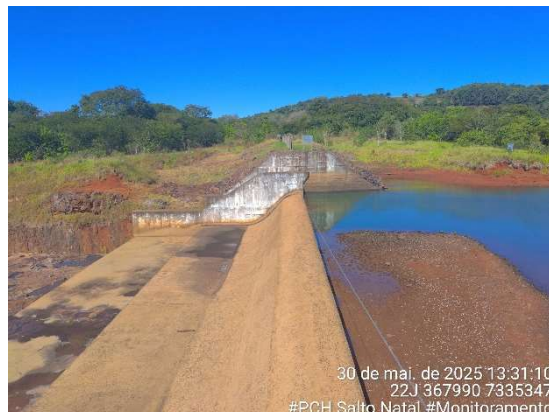
Figura 168 - Vista do vertedouro do reservatório sem presença de macrófitas. Fonte: Cedro Inteligência Ambiental, maio/2025.
