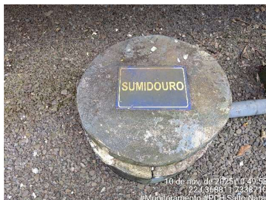
Figura 48 - Sumidouro. Fonte: Cedro Inteligência Ambiental, nov./2025.
