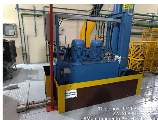
Figura 26 - UHRV da Galeria Mecânica. Fonte: Cedro Inteligência Ambiental, nov./2025.
