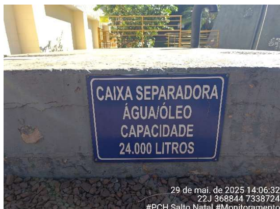
Figura 49 - Sistema separador de água e Óleo. Fonte: Cedro Inteligência Ambiental, maio/2025.
