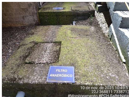
Figura 46 - Fossa séptica e Filtro anaeróbico. Fonte: Cedro Inteligência Ambiental, nov./2025.
