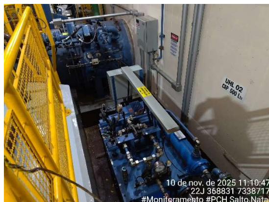
Figura 28 - UHL da galeria mecânica. Fonte: Cedro Inteligência Ambiental, nov./2025.
