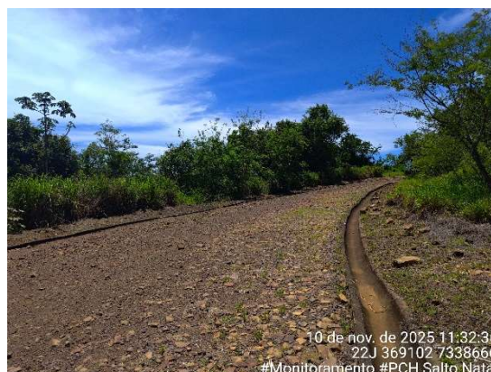
Figura 44 - Sistema de drenagem em ambos os lados da via de acesso. Fonte: Cedro Inteligência Ambiental, nov./2025.
