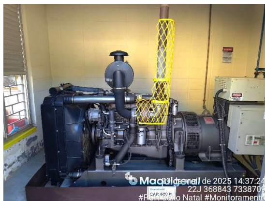
Figura 31 - Gerador diesel GMG. Fonte: Cedro Inteligência Ambiental, maio/2025.
