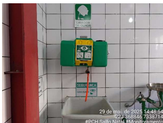
Figura 35 - Kit de mantas e cordões absorventes e lava olhos na área interna na sala de baterias. Fonte: Cedro Inteligência Ambiental, maio/2025.
