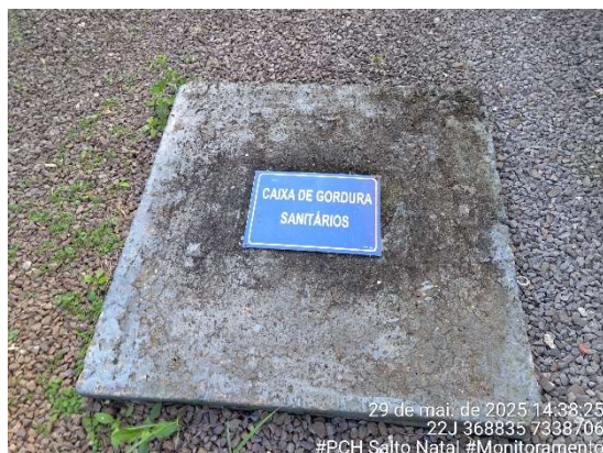
Figura 51 - Caixa de efluentes e caixa de gordura para tratamento primário de efluentes. Fonte: Cedro Inteligência Ambiental, maio/2025.
